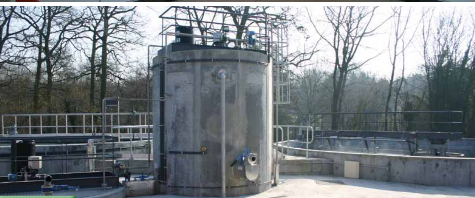
Épaisseur à boues
