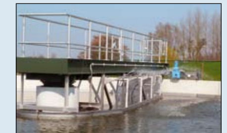
Pont raclé calrificateur
