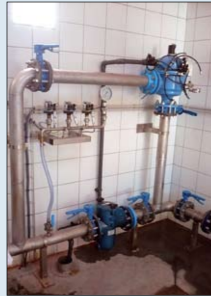
Filtre eaux de service
